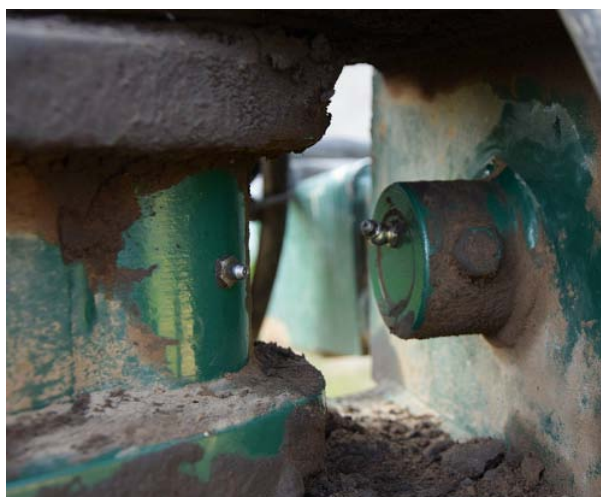
Rys. 10.2 Smarowniczki na układzie zawieszenia
